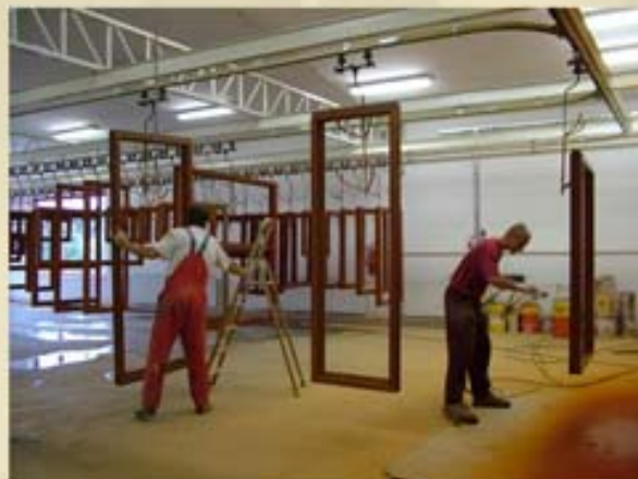
Linka povrchové úpravy v provozu
