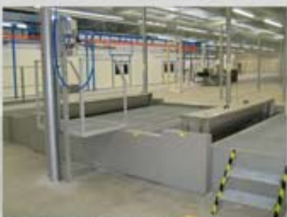
Pohled na máčecí místa s vysunutými vanami
